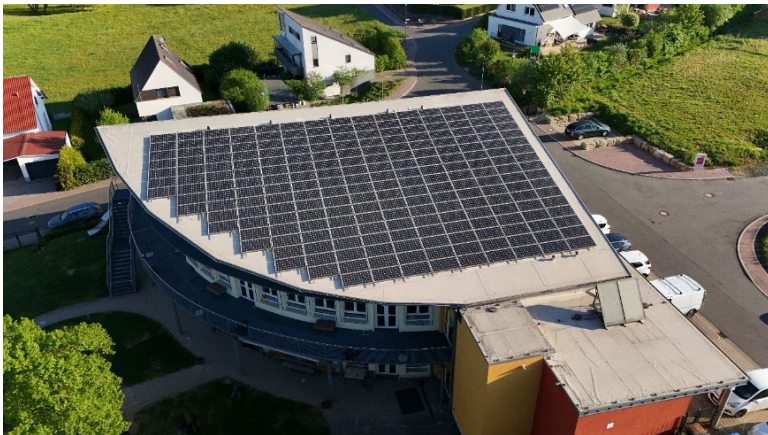
Abbildung 2 PV-Anlage Kita "Kleine Füße" Almendorf
